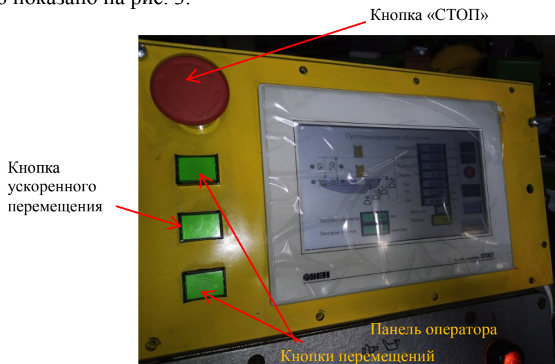
Рис. 3. Пульта управления оборудованием Fig. 3. Equipment control panel
