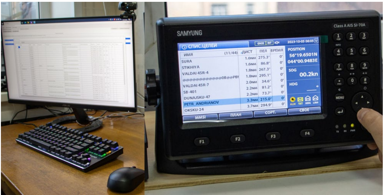
Рис. 7. Аппаратура диспетчерского пункта Fig. 7. Control room equipment
